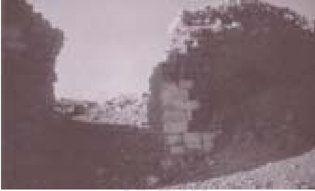
شكل 172 بقايا آثار منزل متصدع بقرية ويغو القديمة
