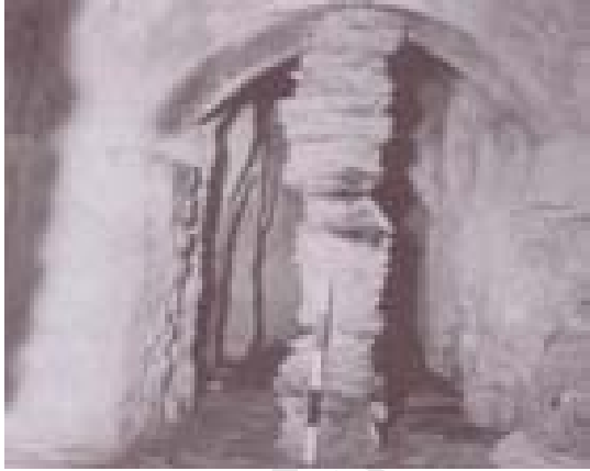
شكل 140 الرواق الشمالي الغربي بمسجد شروس، حيث آثار الترميم
